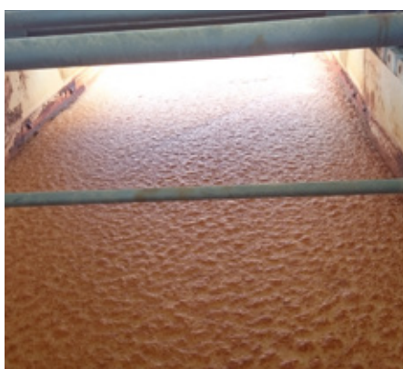
Mit MicroGas™ nachgerüstete DAF-Anlage
